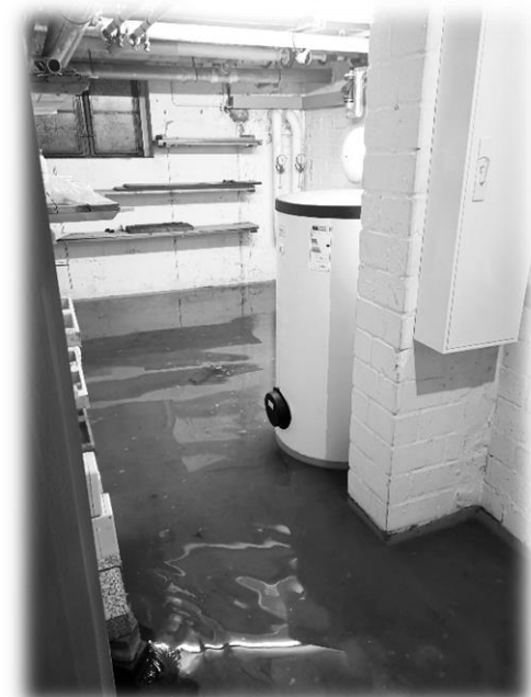
Pfarrhauskeller nach Starkregen unter Wasser
